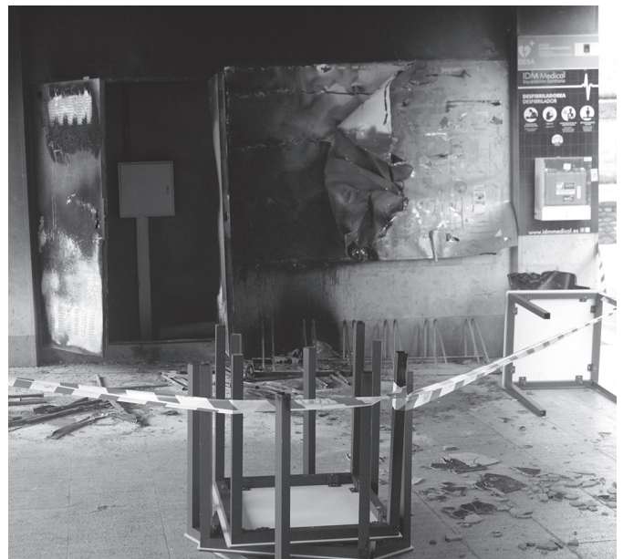
Suteak terrazako aulkia eta mahaiak biltzen dituen eremua kaltetu zuen.
