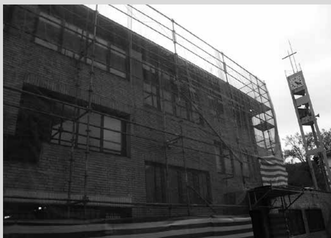
Egitura kalteturik ez dagoen arren, obra zuzendaritzari txosten tekniko bat eskatu zaio.
