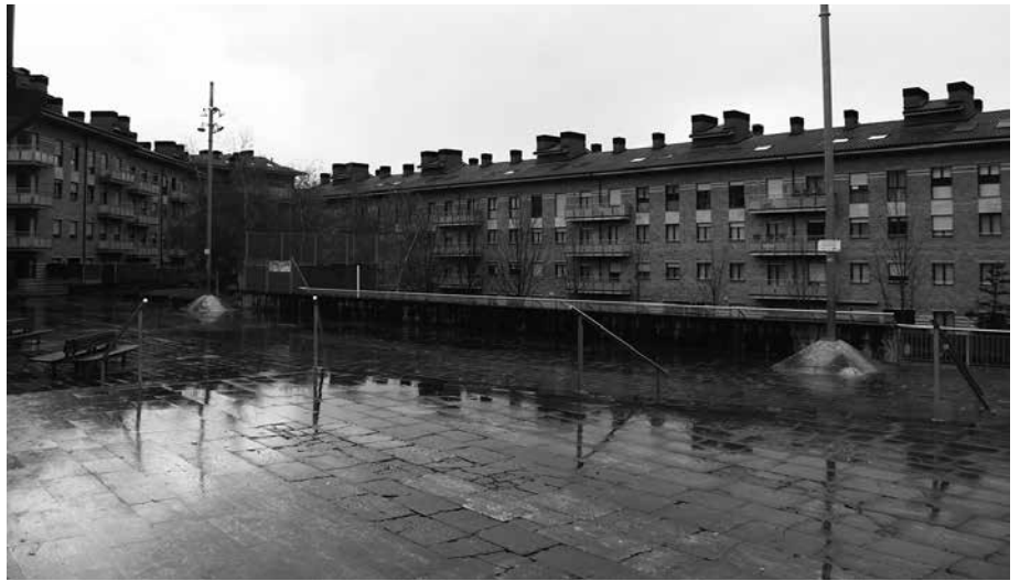
"Udalak beharrezkoa ikusi du plazako zoladura konpontzea, oso egoera txarrean baitago baldosa".
